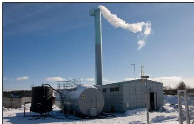
Figur 22: Masala fjernvarmeanlegg, hvor Fortum har testet bio-olje (Lehto, 2013)
